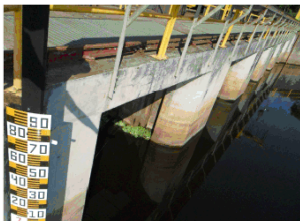
Fig. 3. Detalhe da entrada dos poços de sucção
